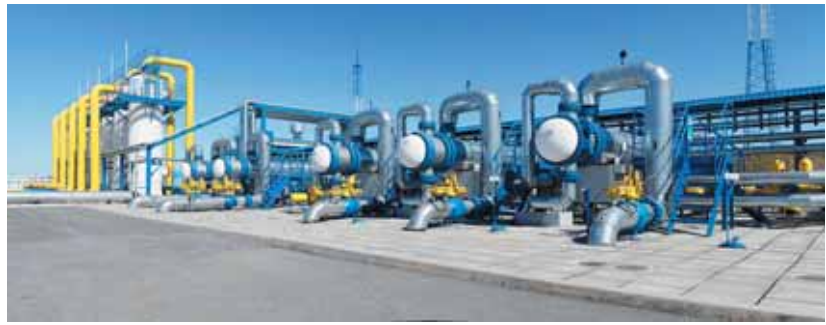
▲ Нижневартовская газораспределительная станция ▲ Nizhnevartovsk gas distribution station
