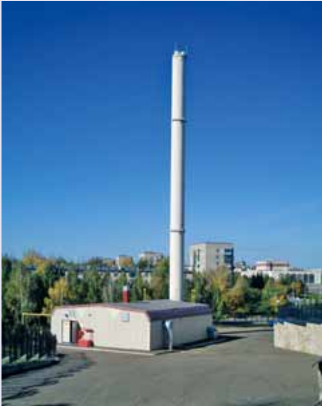
Рис. 1. Блочно-модульная котельная на основе водогрейных котлов фирмы Danstoker-Unicon
